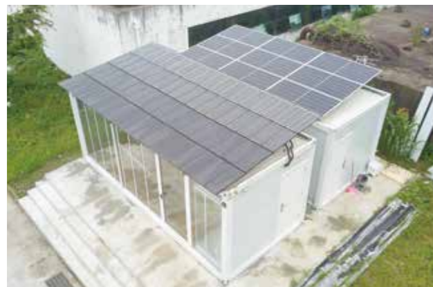
无锡惠山 7.8kW集装箱光伏储能系统
