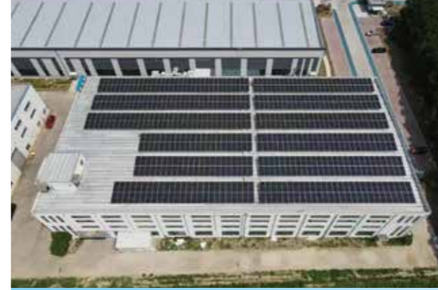
无锡滨湖 源清动力(一期和二期)366kW+682kW水泥屋顶
