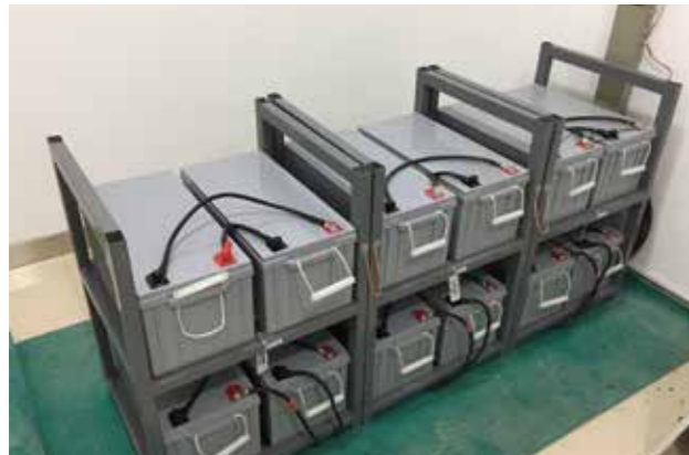
无锡蓝天热电厂18kW离网储能系统
