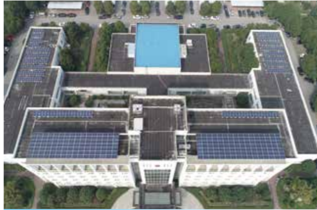
苏州常熟 镇政府大楼200kW商业屋顶 SUZHOU-200kW
