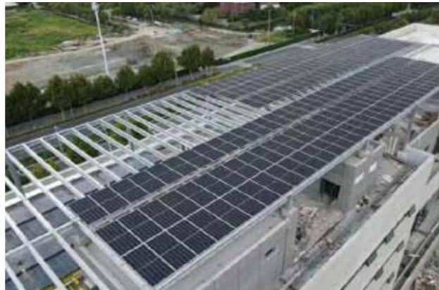
无锡滨湖 地铁4号线综合楼85kW钢构屋顶 WUXI-85kW
