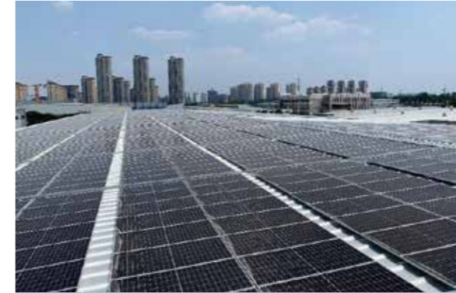
常州新北 蒂业技凯1.4MW彩钢屋顶 (日企)
