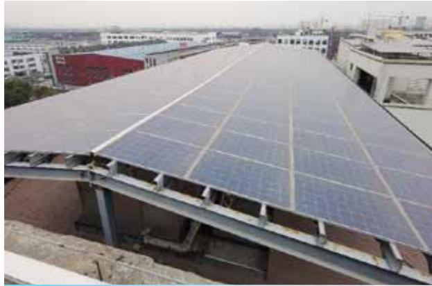
无锡惠山 东阳铸造80kW BIPV屋顶 WUXI-80kW
