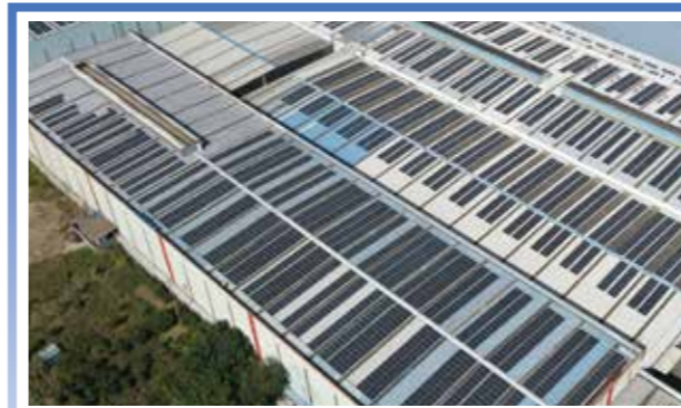
Solar PV Projects 光伏项目
