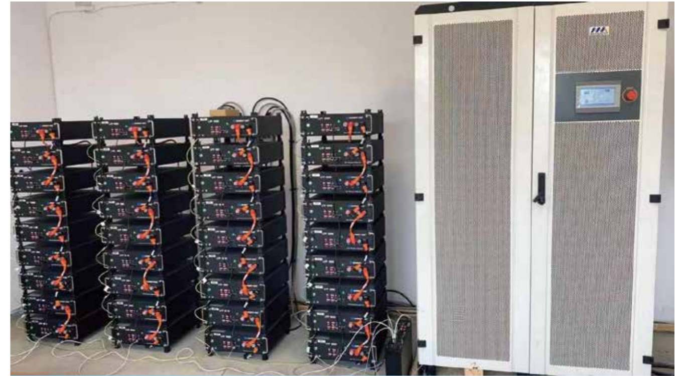
印尼雅加达 90kW/180kWh (锂电)
