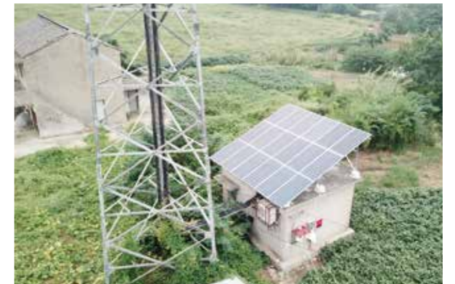
无锡惠山 5.76kW通讯铁塔
