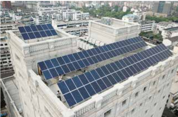
无锡梁溪 人民法院30kW商业屋顶 WUXI-30kW
