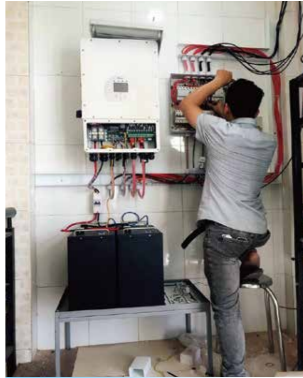
越南胡志明 5kW/10kWh光伏储能
