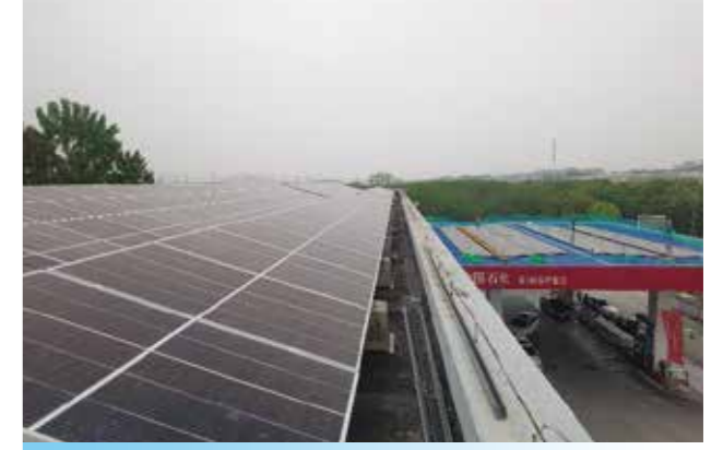
常州新北 中石化110kW加油站分布式
